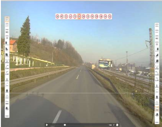
Primjer opasne lokacije sa nezaštićenim krajem sigurnosne barijere
